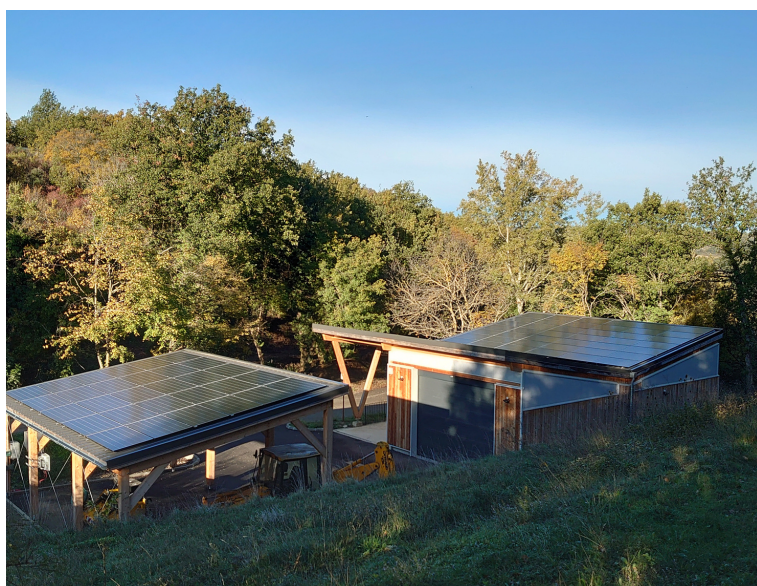
Panneaux photovoltaïques sur l'atelier technique de la commune
