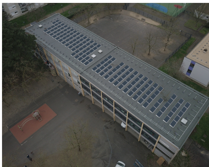
Centrale photovoltaïque sur l'école Jacques Prévert
