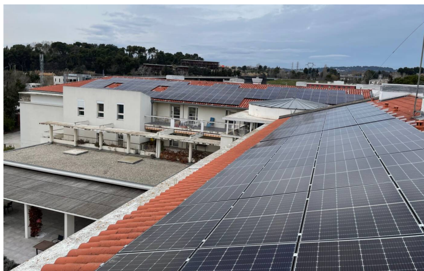
L'installation photovoltaïque sur le toit de la résidence Cartoux à Aix-en-Provence
